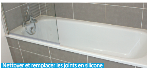
Nettoyer et remplacer les joints en silicone
