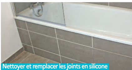
Nettoyer et remplacer les joints en silicone
